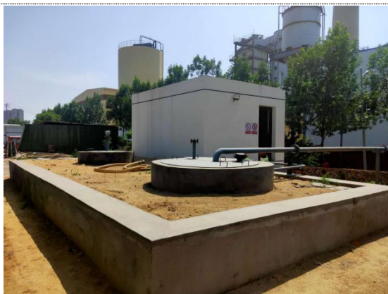
柴油储罐区（待补充）
