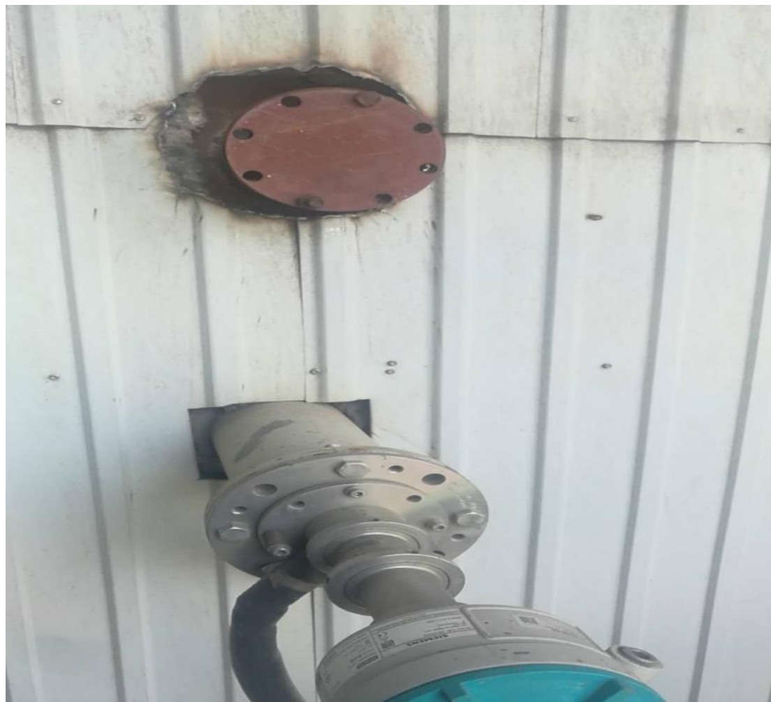
图 5-12 7#锅炉脱硝后、布袋除尘前检测口
