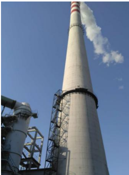
图 2-7 项目锅炉废气处理后烟囱
