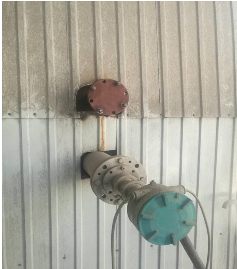
图 5-11 6#锅炉脱硝后、布袋除尘前检测口
