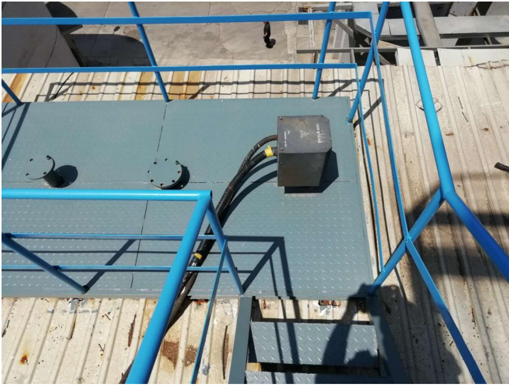
图 5-10 7#锅炉布袋除尘后、脱硫前检测口
