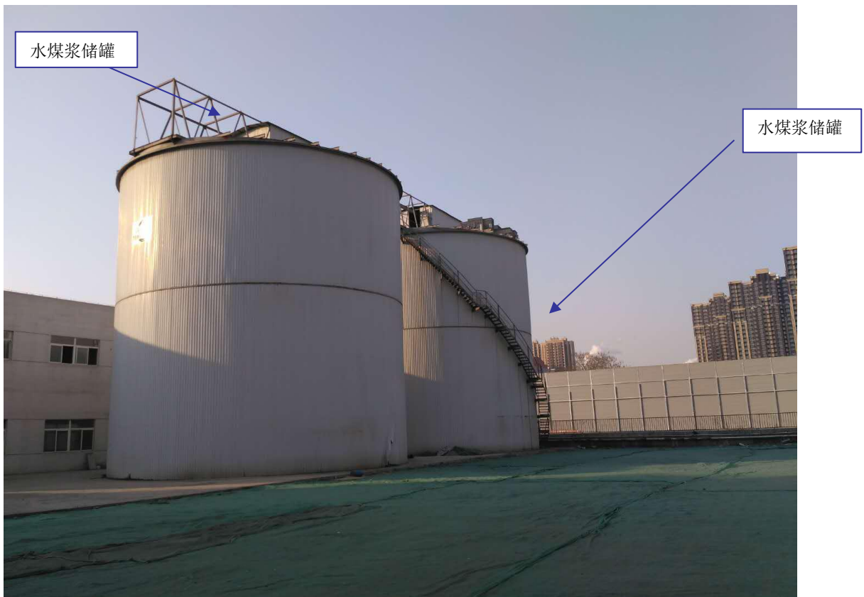
图 2-13 项目水煤浆储罐
