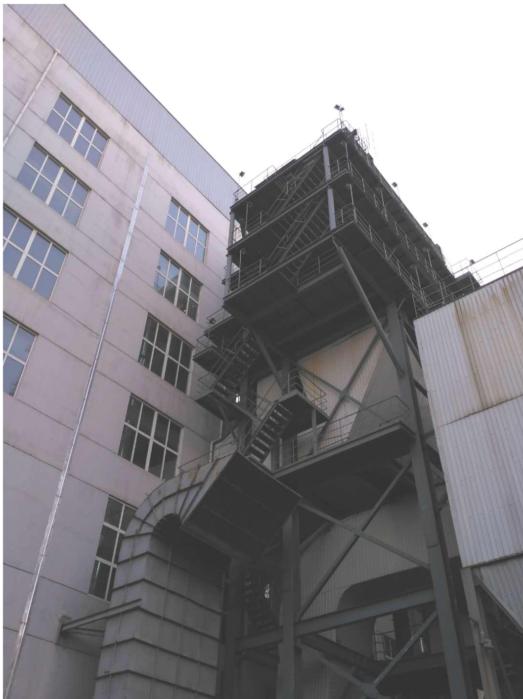
图 2-15 项目脱硝装置
