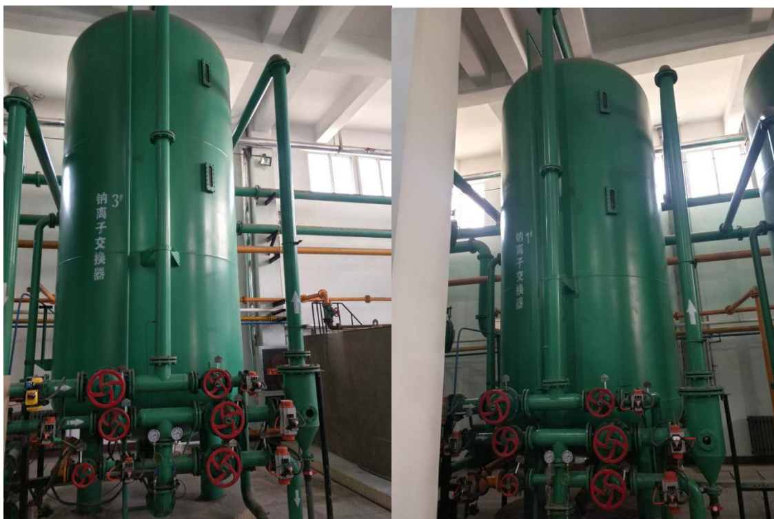
图 2-19 软化水系统钠离子交换器
