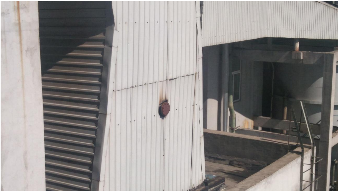
图 5-8 7#锅炉布袋除尘器后检测口
