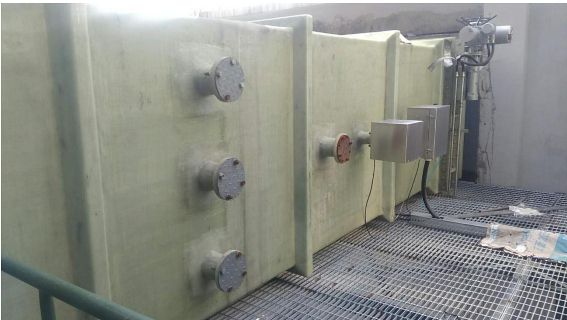
图 5-3 6#锅炉湿电后检测口
