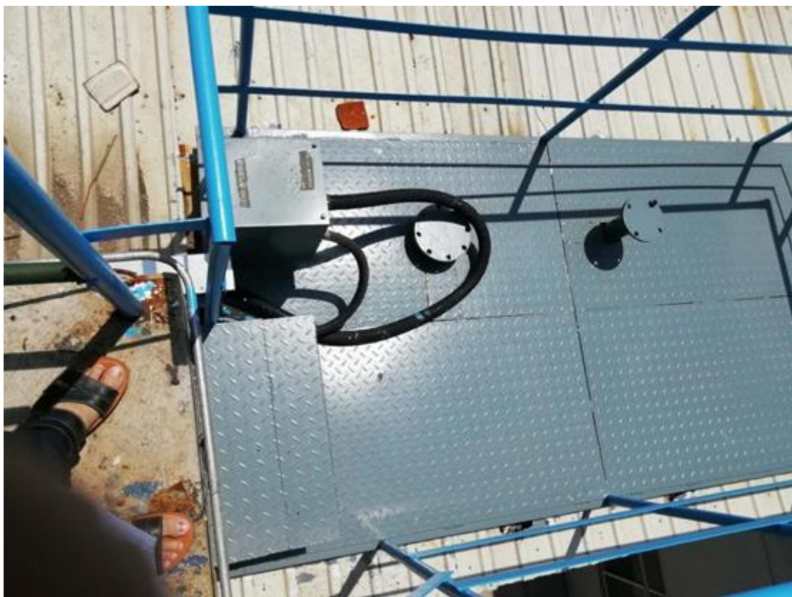
图 5-5 6#锅炉脱硫后、湿电前检测口
